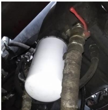
Рисунок 3.12 – Перекрытый кран фильтроэлемента сливного фильтра
