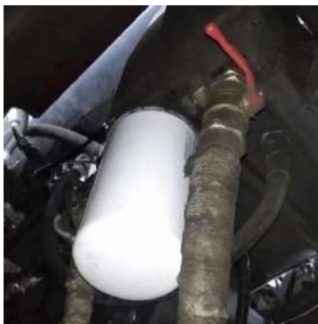
Рисунок 3.12 – Перекрытый кран сливного фильтроэлемента
