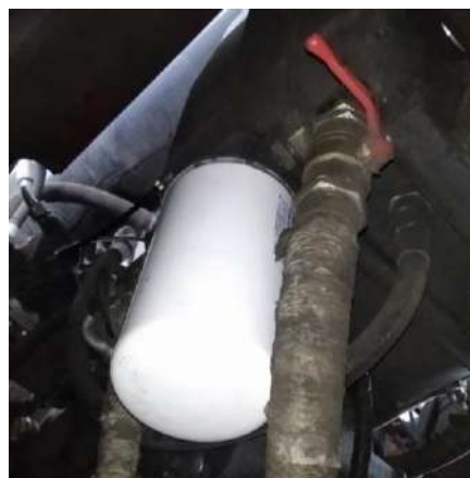
Рисунок 3.10 – Перекрытый кран сливного фильтроэлемента
